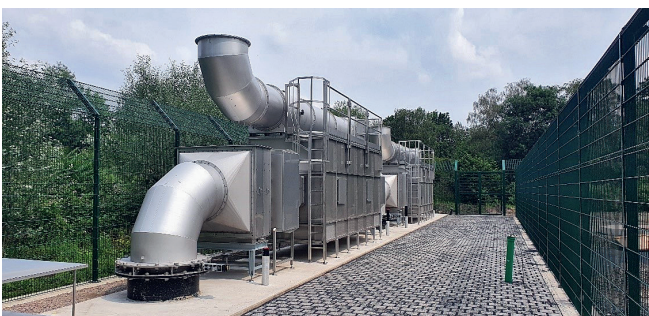
Abb. 8: Beispielstandort mit Fotooxidationsanlagen zur Geruchselimination für 70 000m 3 /h Kanalbewetterungsluft [16]
