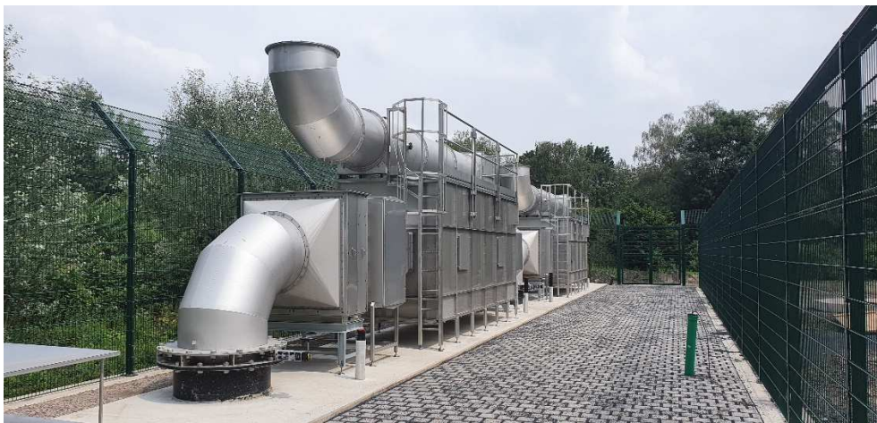
Bild 7: Beispielstandort mit Fotooxidationsanlagen zur Geruchselimination für 70.000m 3 /h Kanalbewetterungsluft [8]
