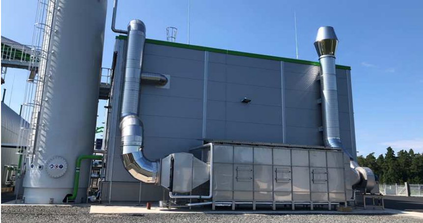
Bild 3: Fotooxidationsanlage Schlammbehandlung, Schweden [6]
